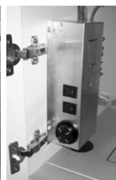
Lämpöaltaan virtakytkin ja termostaatti
