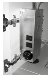
Lämpöaltaan virtakytkin ja termostaatti
