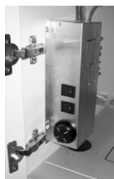
Lämpöaltaan virtakytkin ja termostaatti
