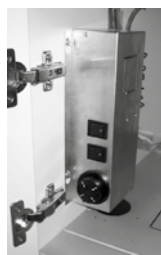
Lämpöaltaan virtakytkin ja termostaatti
