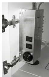
Lämpöaltaan virtakytkin ja termostaatti
