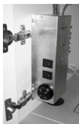
Lämpöaltaan virtakytkin ja termostaatti
