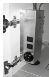
Lämpöaltaan virtakytkin ja termostaatti
